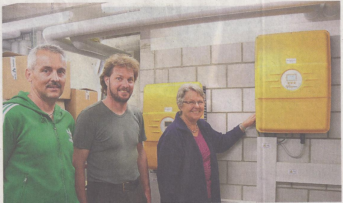
Schulkommissionspräsidentin Anna Dummermuth stellte gestern den Schalter für Sonnenstrom auf «Betrieb», assistiert von Baukommissionspräsident Michael Graf (l.) und Initiator Marcel Ruchti.
